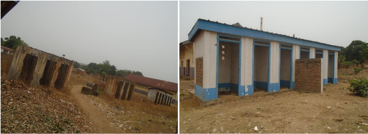
Toilettes de l'école sous-préfectorales de Bozoum/Mission d'évaluation de besoin humanitaire à Bozoum et Nana-Bakassa/photo ONG-AFEB
